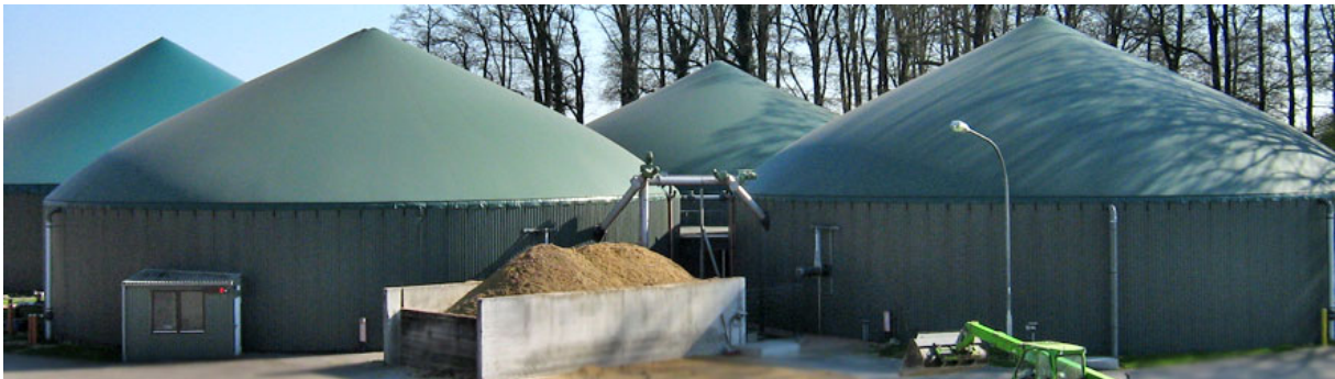
Abbildung 18: Biogasanlage Ankum (bioenergie-ankum.de 2020).
